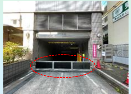
↑水災害に備えた資機材(防水板)の写真
