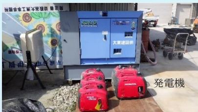
↑ 非常用電源の写真
