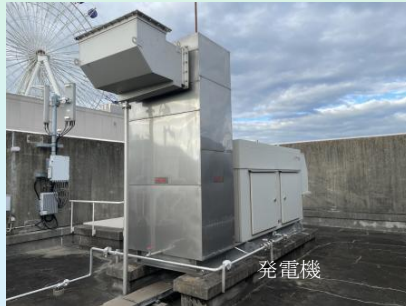
↑非常用電源の写真
