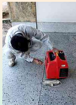
↑非常用電源の写真
