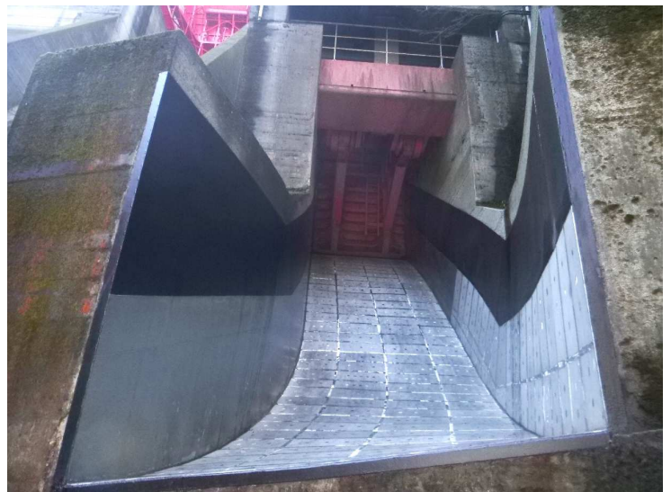
●コンジットゲート ダムの内部に設置してある油圧式のゲートで、比較的小規模な出水時の流量調節に使用します。
