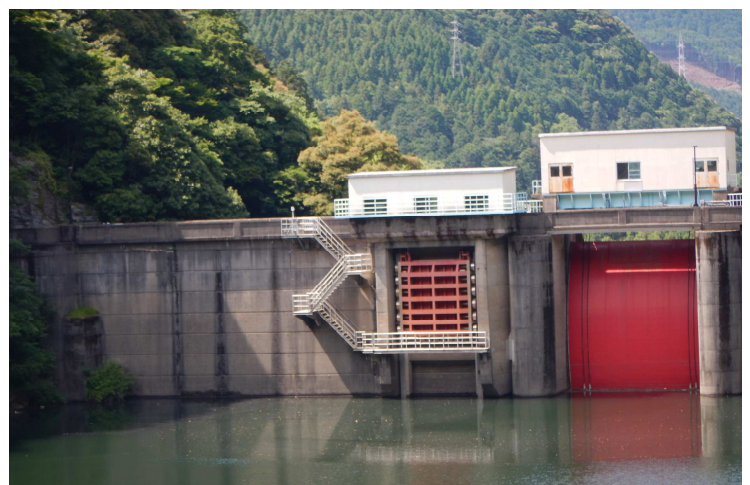
●コンジット予備ゲート コンジットパイプの上流側に設置しており、コンジットゲート及びコンジットパイプの点検時に使用します。
